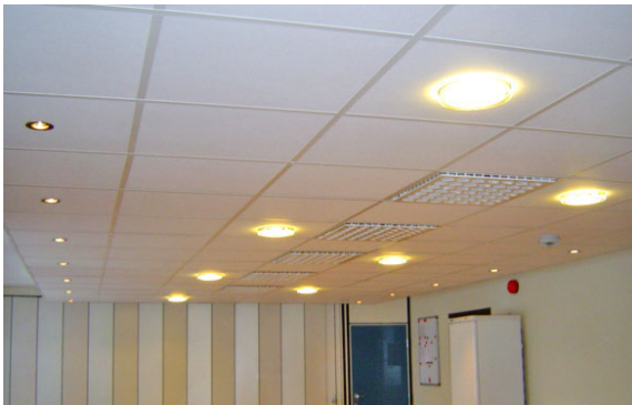
Belysning i vår kantine på E-Verket.
